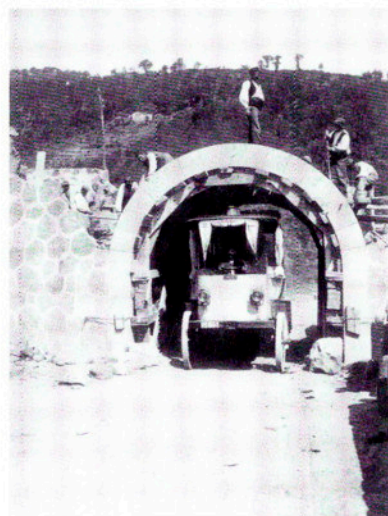
Procés de construcció de la primera de les arcades del pont. Calia veure si passava el cotxe. Any 1908.
